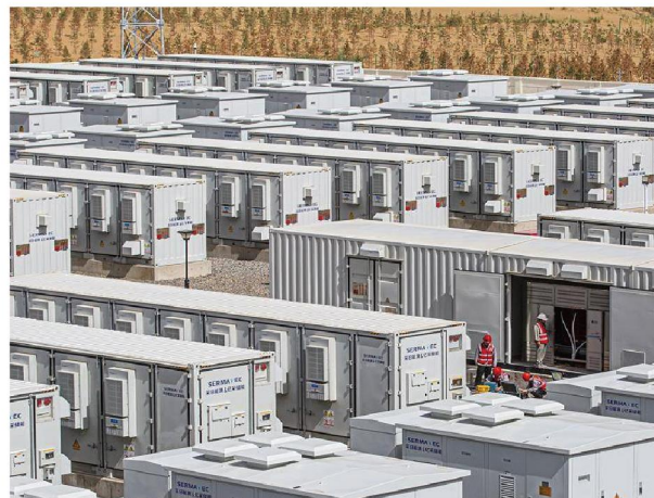
蒙西基地库布其200万千瓦光伏治沙项目 1#储能电站（80MW/160MWh）
